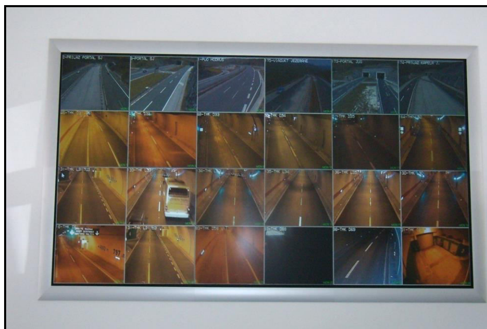
Sl. 19. Video zid u COKP-a Tunela Mala Kapela [12]
