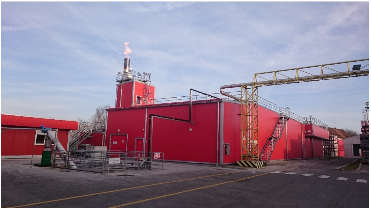
Slika 7. Uređaj za obradu tehnoloških otpadnih voda (Heineken Hrvatska).
