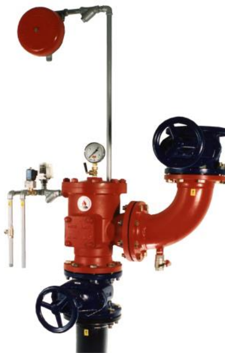
Sl. 9. Drencher stanica [14]
