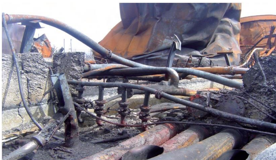
Slika 24: Prikaz mjesta razaranja zida sabirnog prostora zbog termičkog rastezanja cijevi pod utjecajem visokih temperatura u požaru [6].
