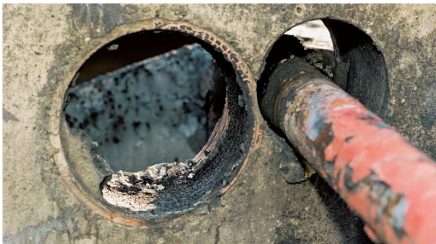
Slika 25: Gubitak ispune na mjestu prolaska cijevi kroz zid sabirnog prostora [6].
