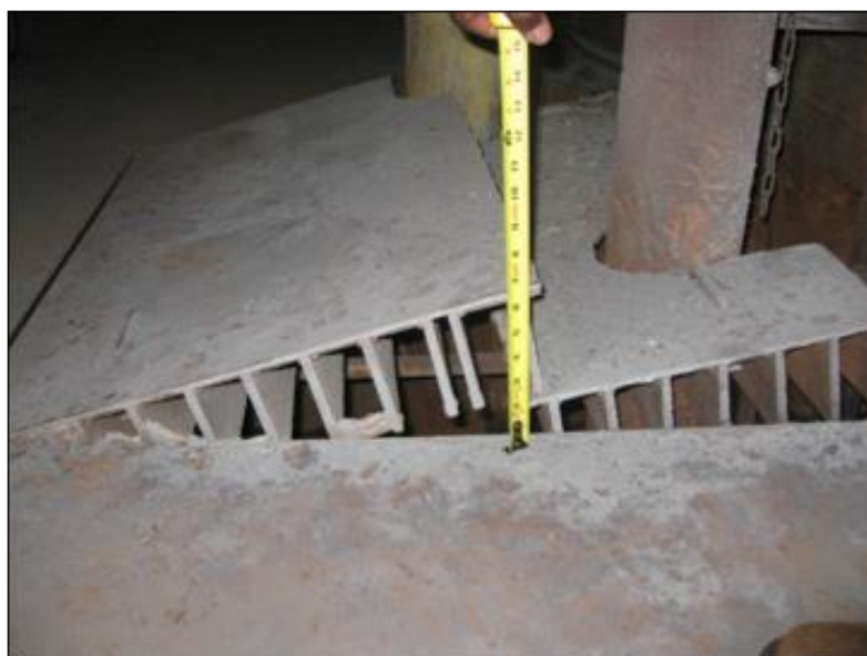
Slika 12. Pomicanje pokrovnih ploča izazvano eksplozijom vodika [14].
