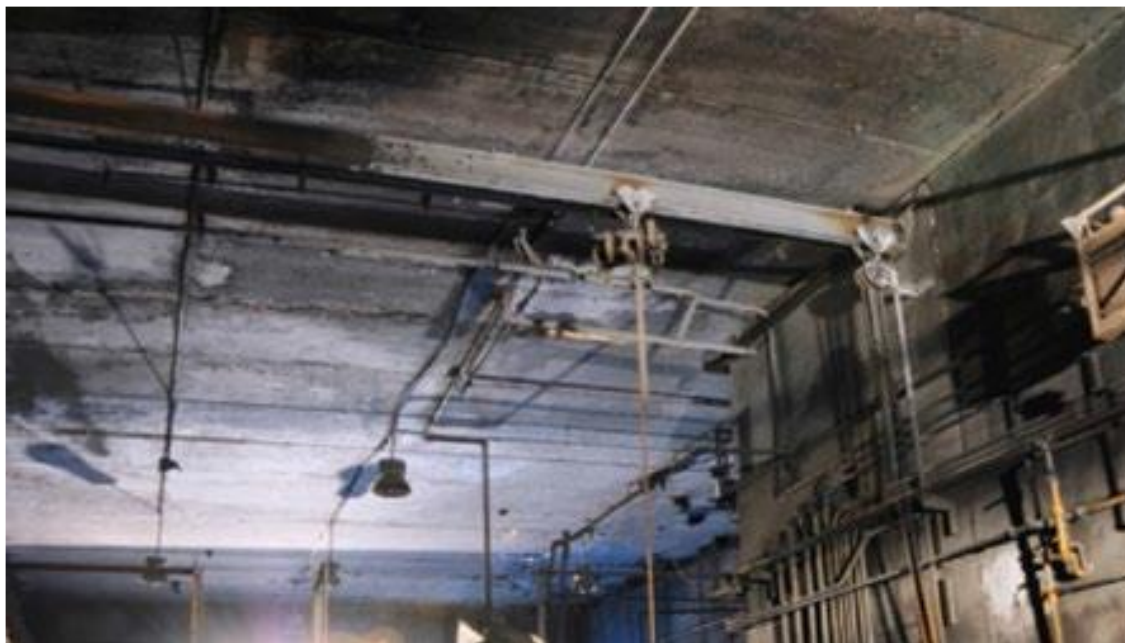
Slika 5. Strop prostorije za miješanje i prešanje nakon eksplozije [11].
