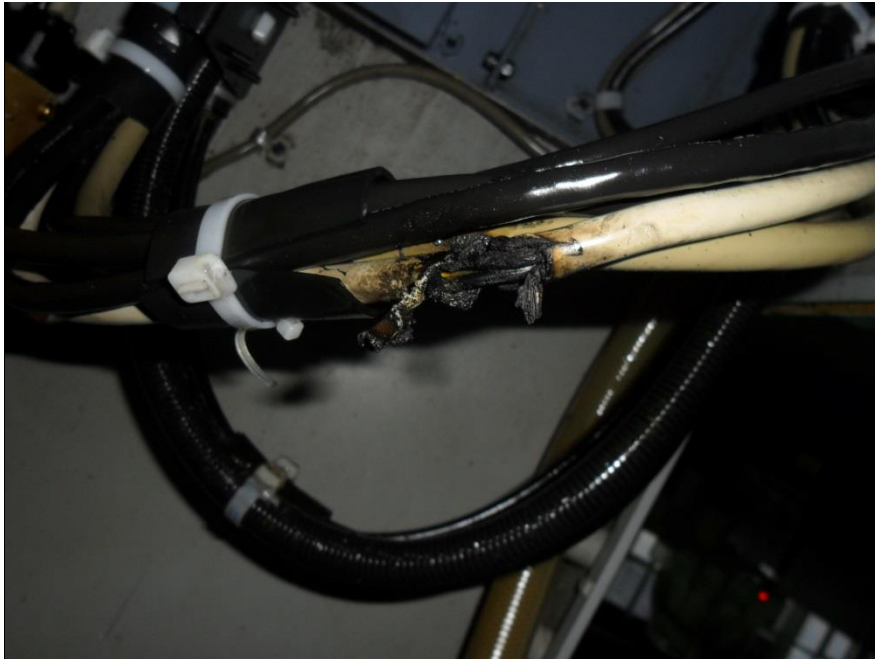
Slika 17: Oštećenje kablova na pregibnim dijelovima
