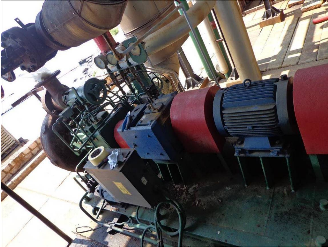
Fotografija 3.1 Stanje turboagregata prije demontaže
