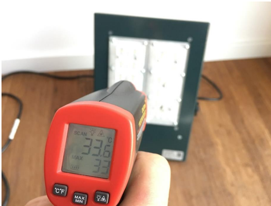
Slika 36 Mjerenje temperature kućišta
