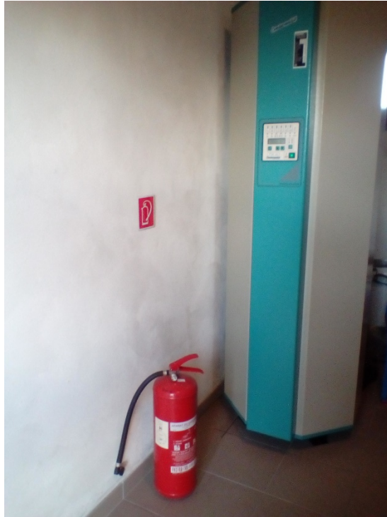
Slika 22. Vatrogasni aparat postavljen u spremištu gdje kojem se nalazi uređaj za solarnu energiju [14]
