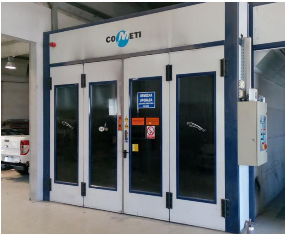
Sl. 35. Prikaz smještaja i izvedbe komore za lakiranje
