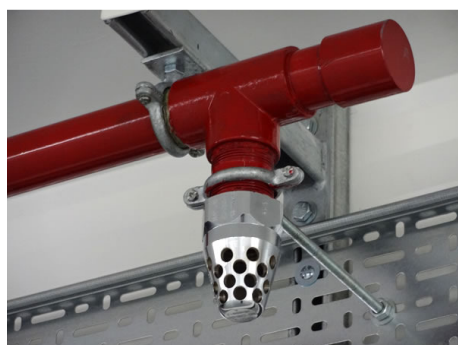
Sl. 29. Primjer mlaznice za plin FM-200 postavljene na kraj cjevovoda
