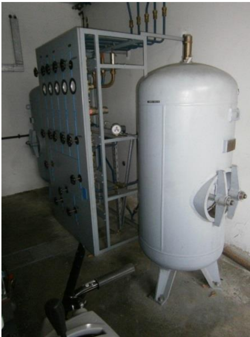
Slika 16. Spremnik zraka s razdjelnikom
