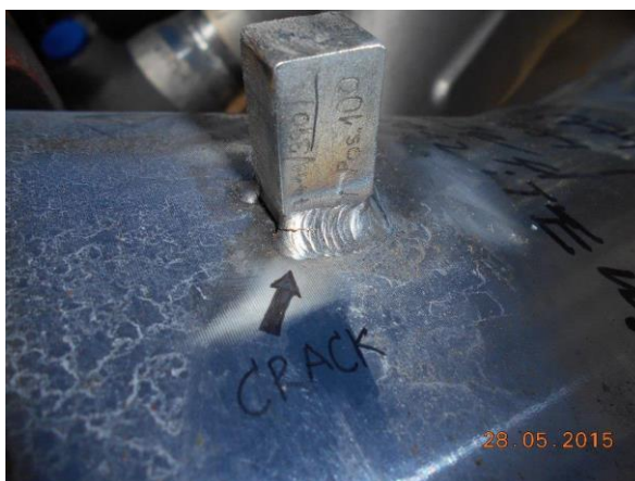
Slika 8. Pukotina otkrivena vizualnom kontrolom [11]
