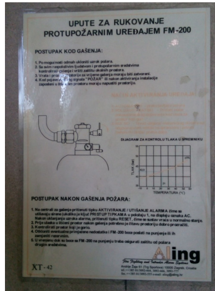
Sl. 48. Prikaz skraćenih uputa postavljenih uz centralu i spremnik plina FM-200
