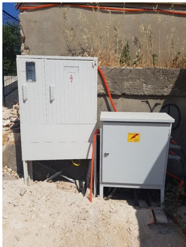
Sl. 9. Razvodni ormar postavljen na gradilištu
