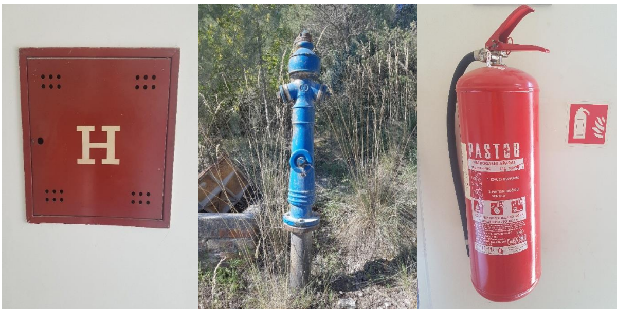
Sl. 3. Zidni i nadzemni hidrant, vatrogasni aparat
