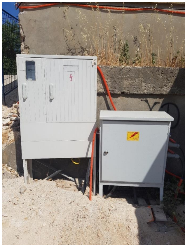
Sl. 9. Razvodni ormar postavljen na gradilištu
