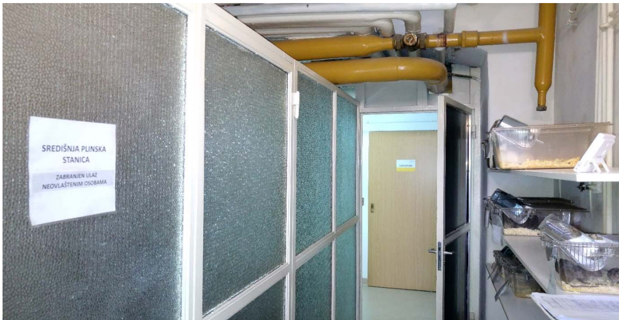
Slika 4: Predodžba prostora: središnja plinska stanica: Izvor autora
