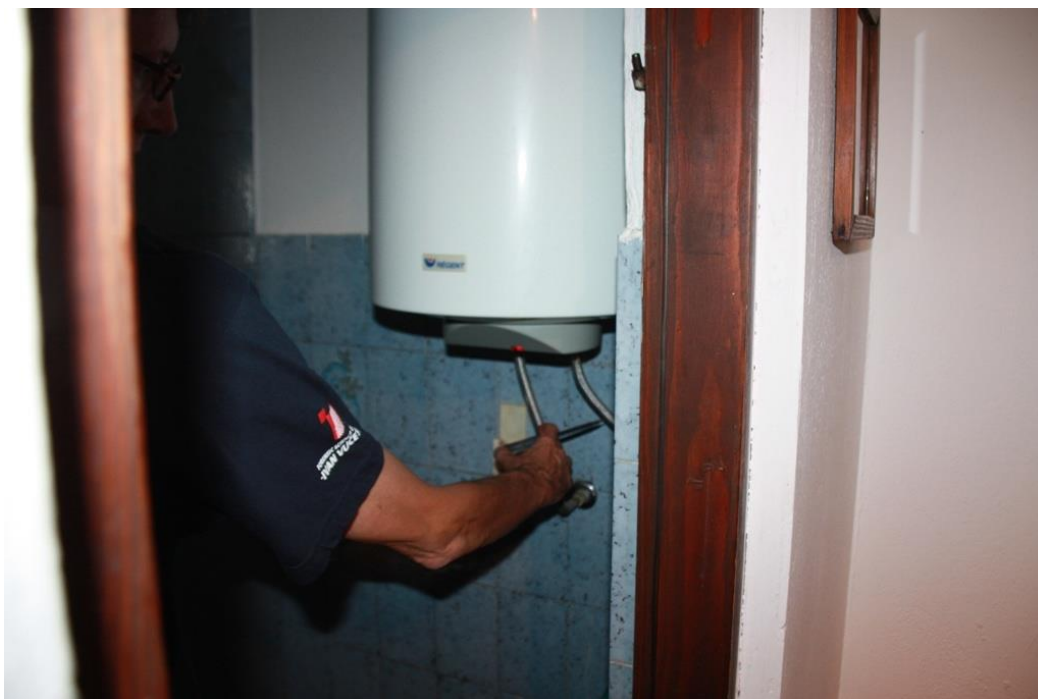
Slika 32: Ispitivanje električnih uređaja (uređaj za zagrijavanje vode) [20].
