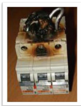
Slika 15: Prikaz spaljenog osigurača [14].
