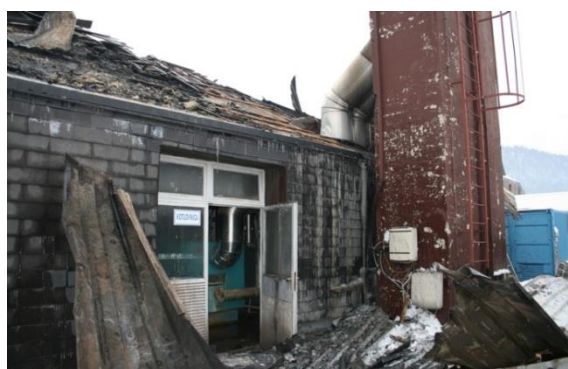
Sl.13. Potpuno izgorjeli objekt [15]
