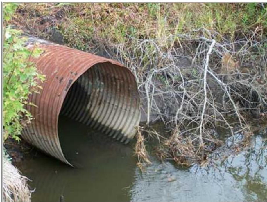
Slika 1. Prikaz neadekvatnih objekata za odvodnju otpadnih voda
