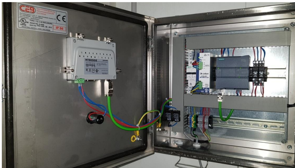
Slika 14. Elektro ormar / Autor slike 14: Antun Omrčen
