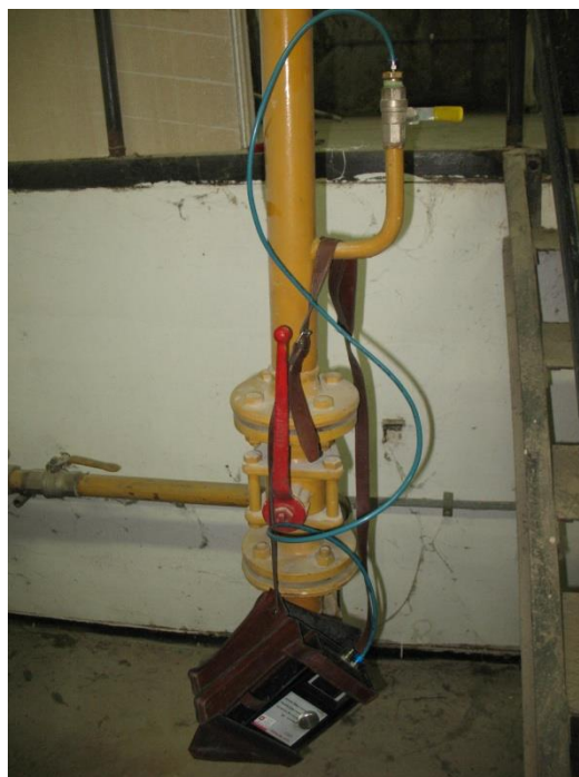
Slika 21. - Digitalni mjerni uređaj spojen na instalaciju
