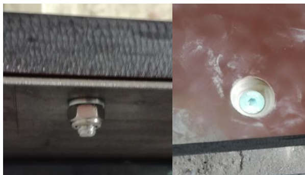
Slika 83. Stegnute ploče odozdo (lijevo) i odozgo (desno)
