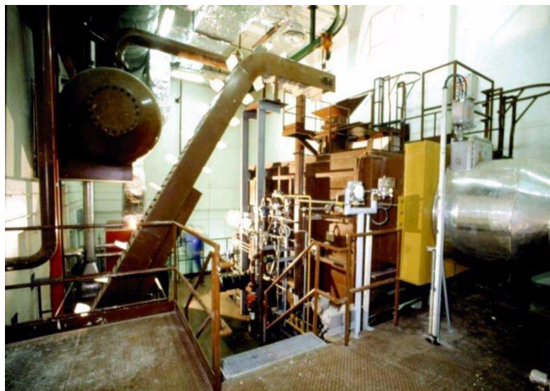
Sl. 11 Peć za spaljivanje radioaktivnog otpada
