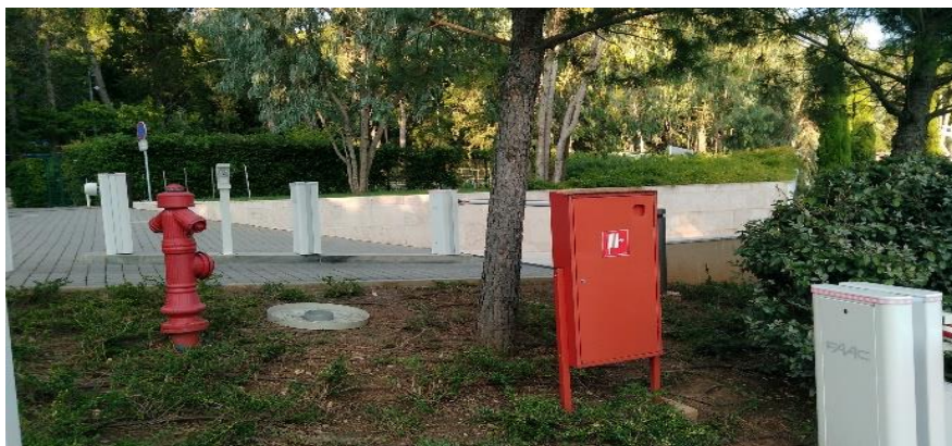
Slika 19. Vanjska hidrantska mreža oko objekta-nadzemni hidrant s opremom [10]
