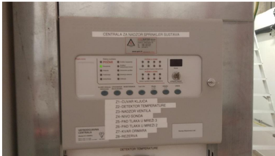
Slika 20. Centrala za nadzor sprinkler sustava [10]
