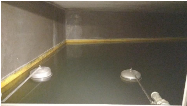
Slika 27. Akumulacijski spremnik (sprinkler bazen) [10]
