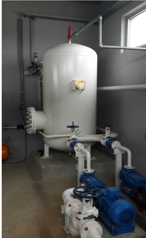
Sl. 22. Hidroforska posuda i pumpe [vlastita fotografija]
