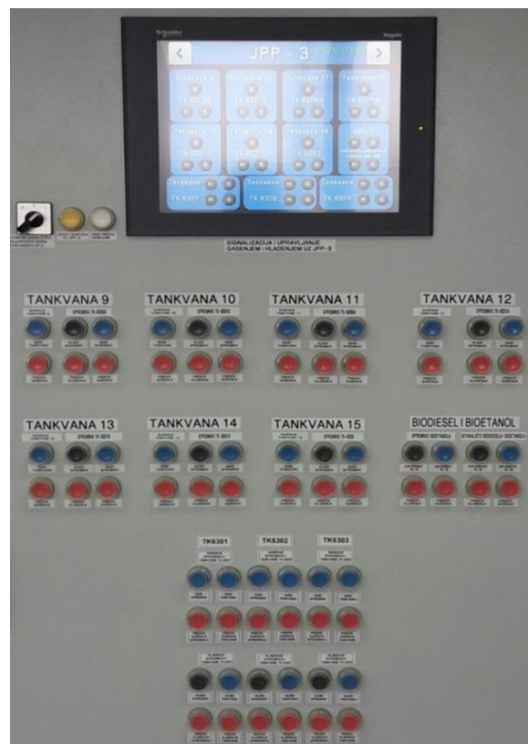
Sl. 32. Izgled upravljačkog ormara [12]
