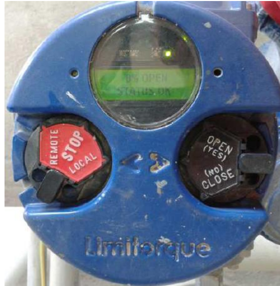
Sl. 26. Upravljačke komande ventila [vlastita fotografija]
