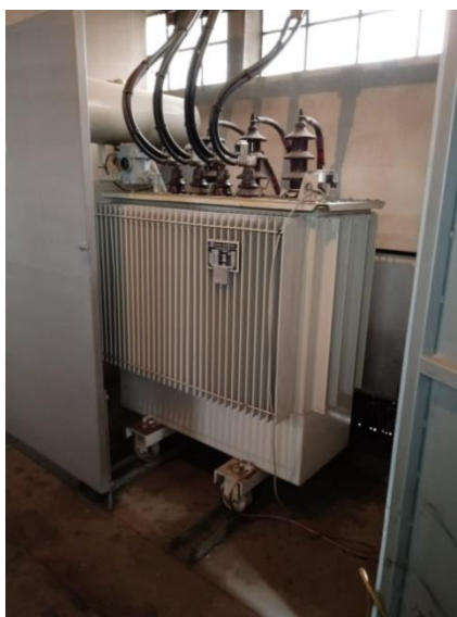
Slika 23. Predodžba transformatora, rebara hladnjaka i naponskih priključnica.
