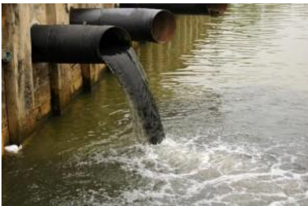
Slika 3. Ispuštanje otpadnih voda
