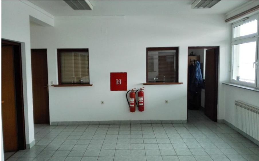
Slika 26. Hidrantski ormarić broj 1 (prostorija 3) zgrade
