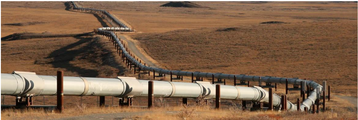
Slika 5. Primjer transportnog cjevovoda [7]
