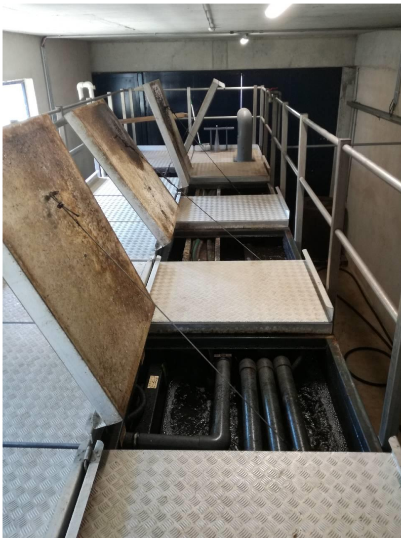
Slika 23. Kontejnersko postrojenje za pročišćavanje.
