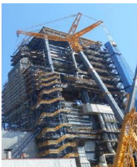
Slika 35. Prikaz DENOX postrojenja. [17]
