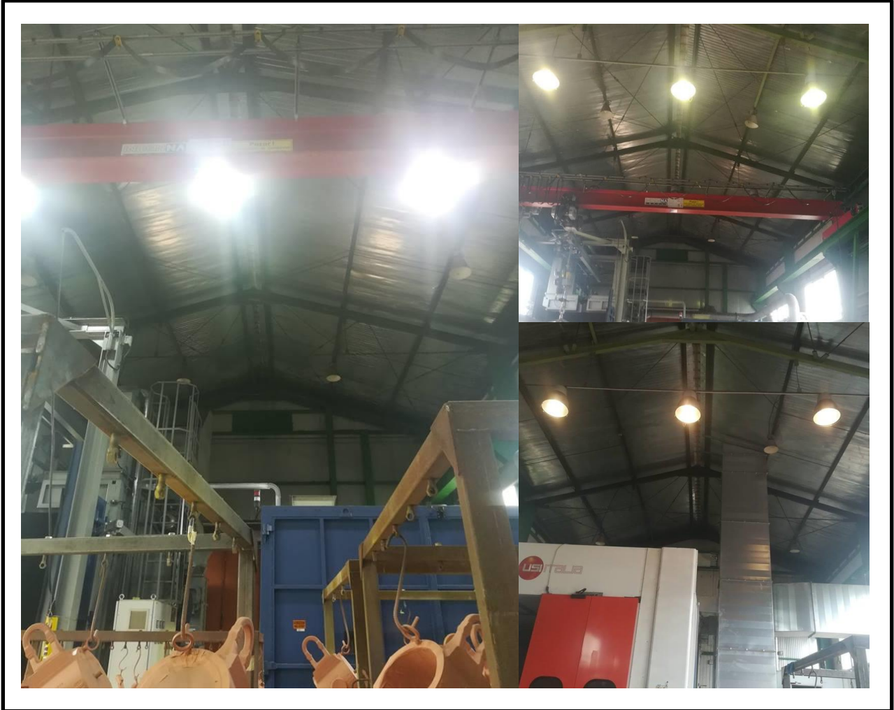
Slika 21: Pogon lakirnice i antikorozivne zaštite
