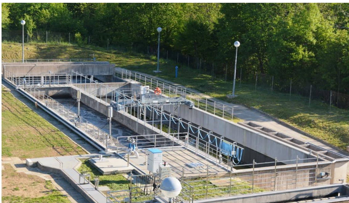
Slika 6. Uređaj za pročišćavanje otpadnih voda
