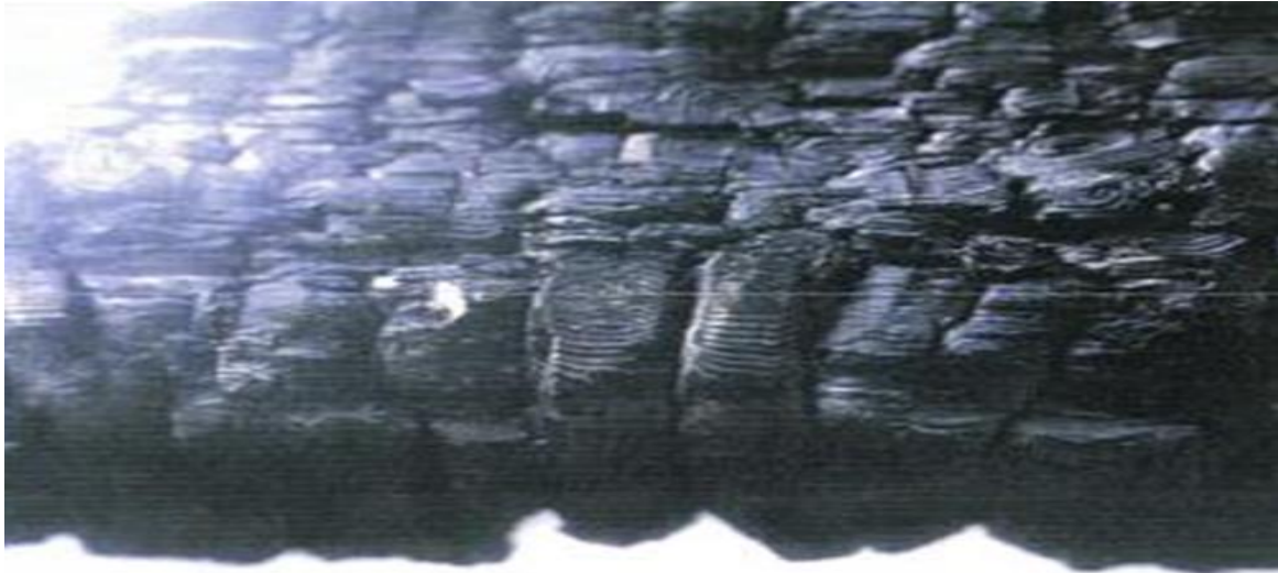
Slika 11. Prikaz izgaranja drvene mase gdje nastaju oštećenja, popularno nazvana krokodilska koža.[22]
