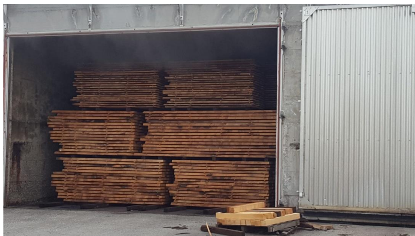
Slika 26. Sušara drvene piljene građe [26]
