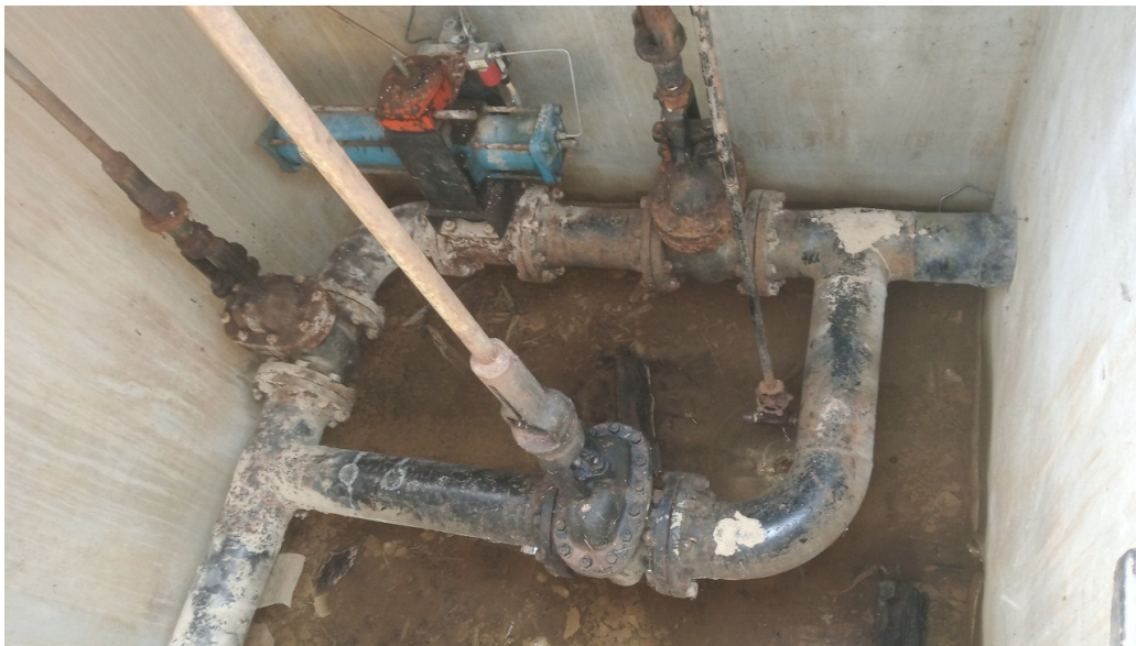
Slika 26 Zasunsko okno s aktivacijskim uređajem stabilnog sustava s raspršenom vodom (drencher) [14]
