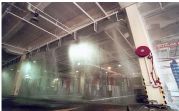
Slika 13. Sustav za prskanje vode pod tlakom [14]
