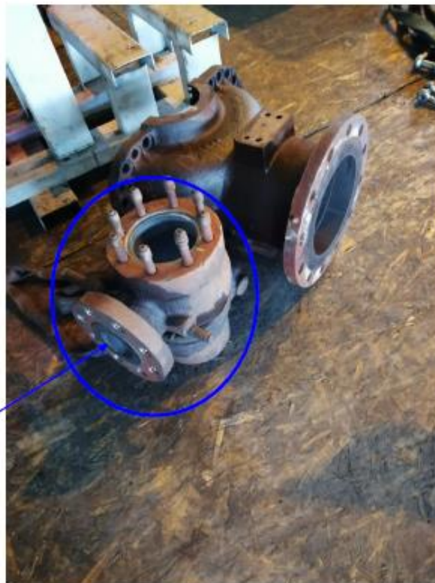
Kućište BZV-a, ulazni dio
