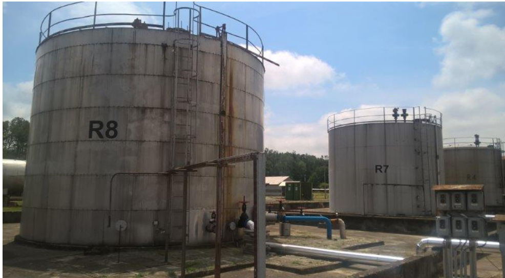
Slika 12. Spremnici slane vode ( R- 7 i R- 8 ) [2]
