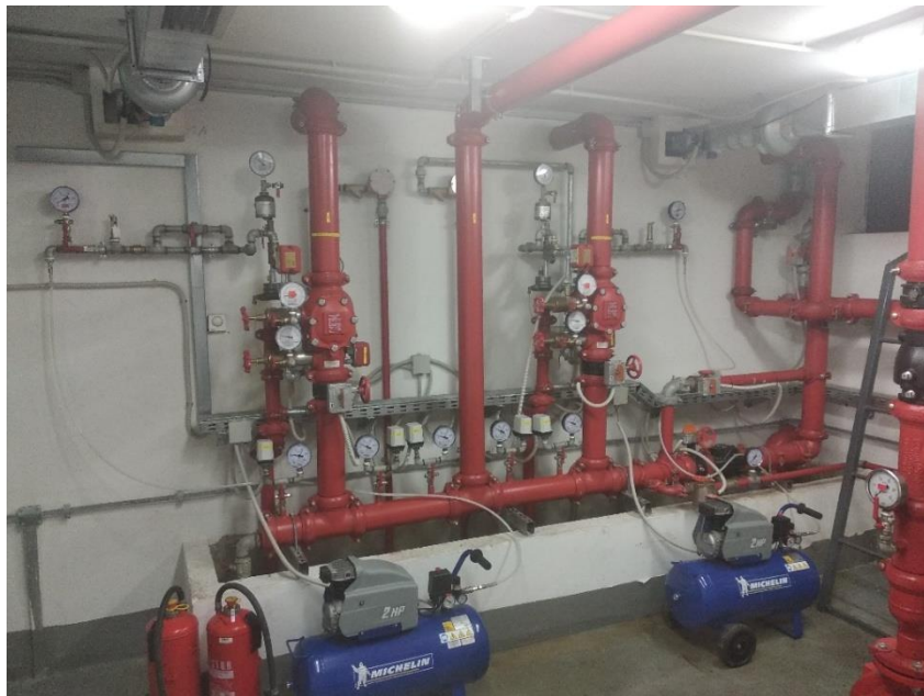
Sl. 13. Sprinklerska stanica se dva "SUHA" sprinkler ventila [16]
