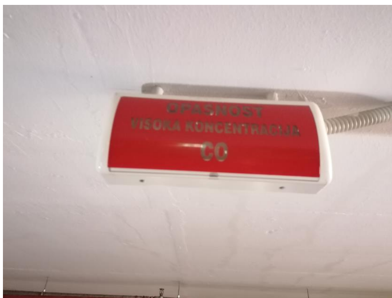
Sl. 21. Svjetlosna signalizacija opasnosti visoke koncentracije CO [24]
