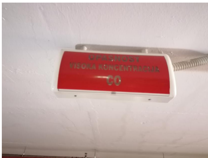
Sl. 21. Svjetlosna signalizacija opasnosti visoke koncentracije CO [24]
