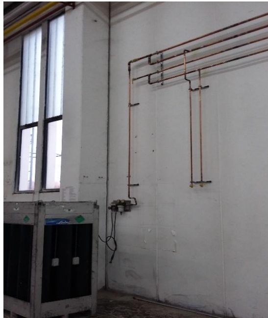
Slika 4. Bakar cjevovod sa priključenim snopom boca dušika [16]
