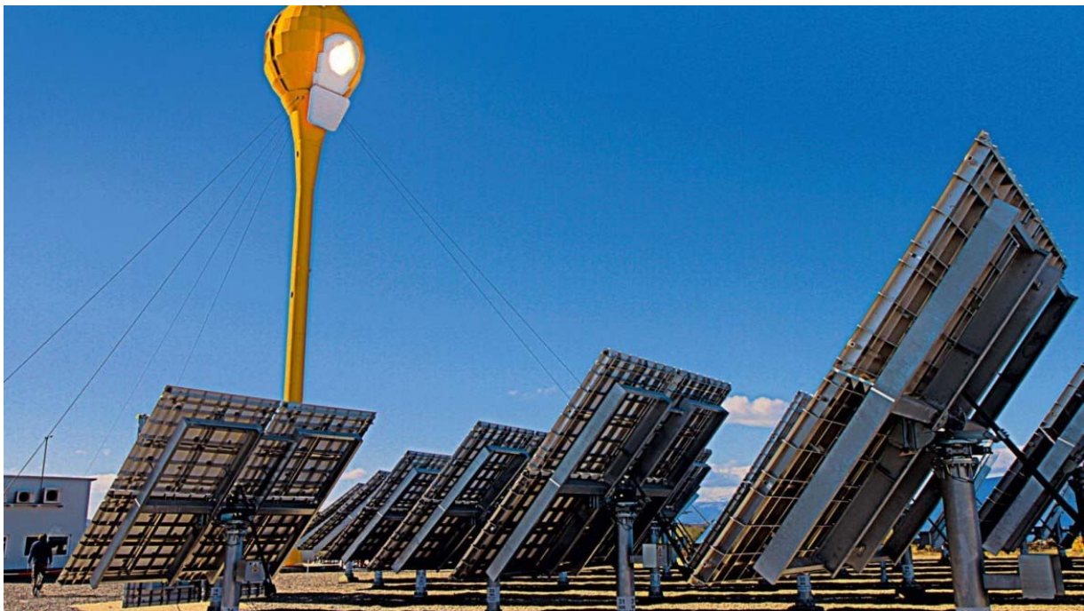
Slika 11. Pogled na heliostate u elektrani sa sunčevim tornjem (Ethiopia) [8]
