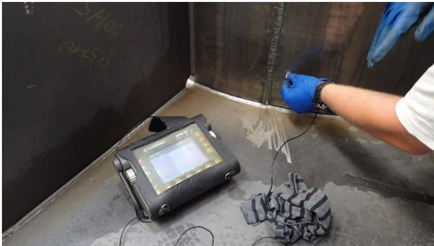
Slika 54. Ultrazvučno ispitivanje vertikalnog tehnološkog zavora plašta izlazne cijevi. [2]
