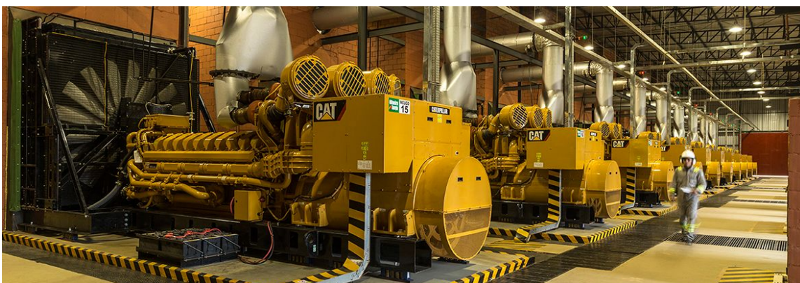
Slika 15. Izgled paralelno spojenih generatora u potpalublju platforme
