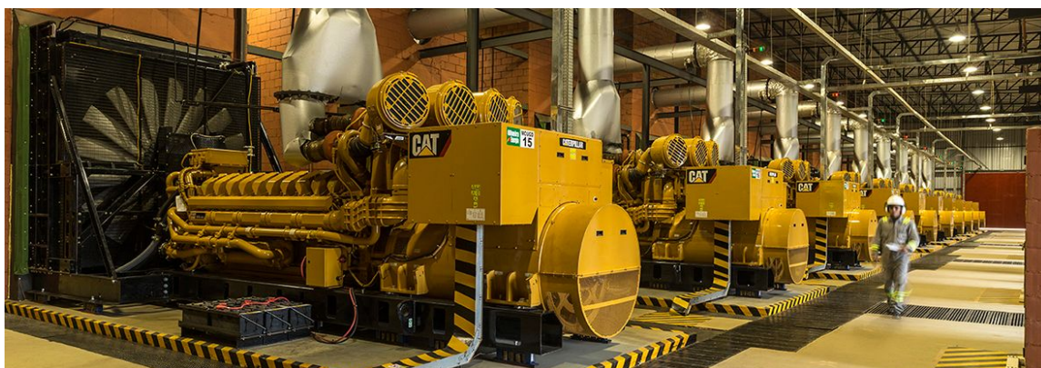
Slika 15. Izgled paralelno spojenih generatora u potpalublju platforme
