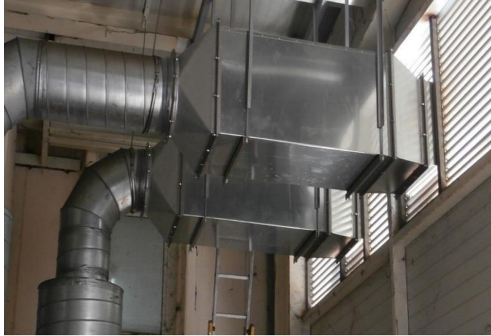
Slika 7. Prigušivači buke u ventilacijskom sustavu
