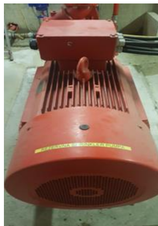
Sl. 10. Rezervna sprinkler pumpa [19]
