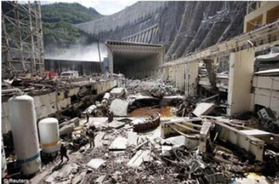
Slika 21. Šest uništenih generatora na hidroelektrani Sayano-Shushenskaya [40]
