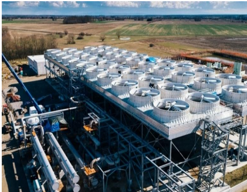
Slika 16. Geotermalna elektrana Velika 1 [24]
