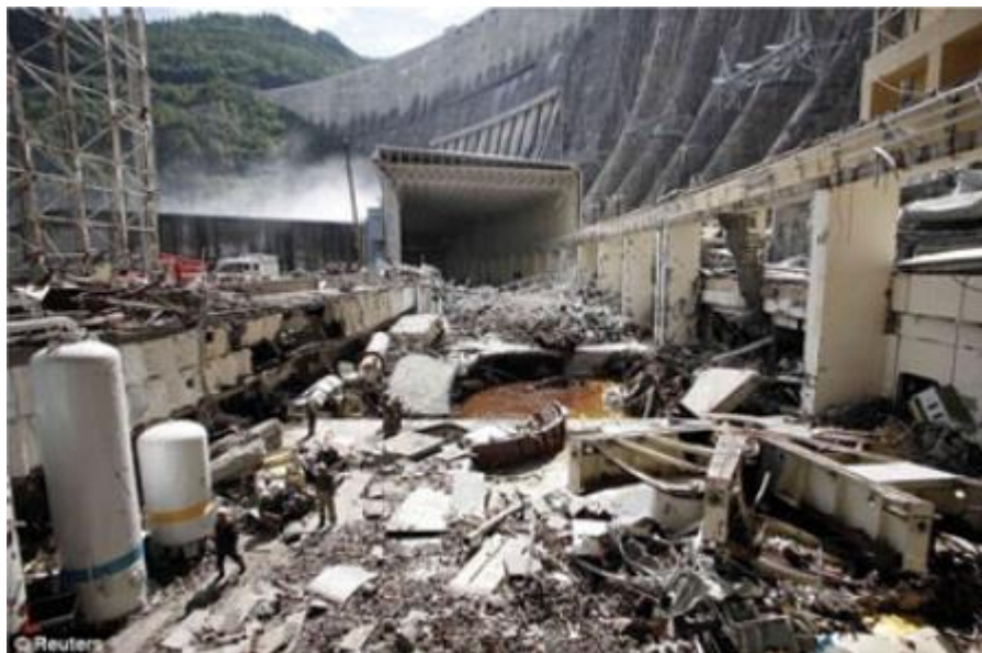
Slika 21. Šest uništenih generatora na hidroelektrani Sayano-Shushenskaya [40]
