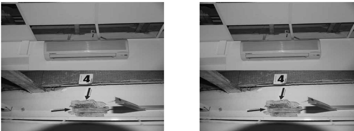
Slika 1. Mjesto oštećenja na električnoj instalaciji. Preuzeto iz Papić N., 2017.
