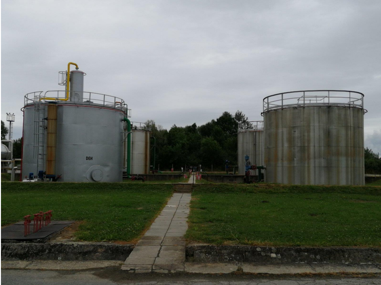
Slika 3. Spremnici nafte (desno) , dehidrator (lijevo) [19]
