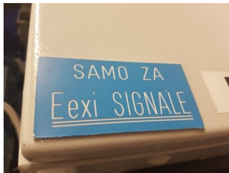
Slika 23. Oznaka na elektroormaru u kojem se nalaze pex uređaji
