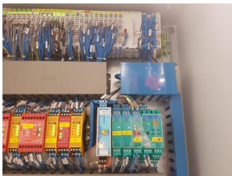
Slika 24. Samosigurni krugovi u elektroarmarima označeni su plavom bojom. Uređaji koje nazivamo izolaciona pojačala ili barijere su konstruirani, ispitani, certificirani i označeni prema normama. Samosigurni strujni krug nalazi se u opasnom području ali zbog niskog napona i male struje ne može izazvati propaljivanje i eksploziju eksplozivne smjese.
