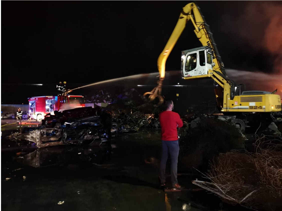
Sl. 14. Požar CE-ZA-R d.o.o. [26]
