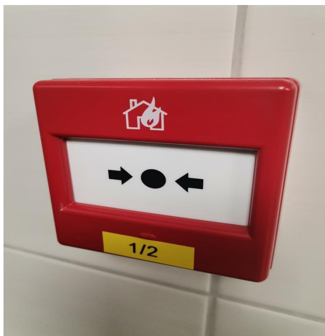
Slika 8 - Ručni javljač požara Fulleon, ugrađen u restoranu „Labudovac“
